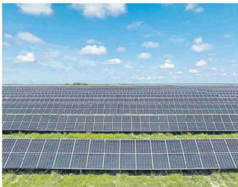
L'impianto fotovoltaico di Plenitude a Corazon (Texas)
