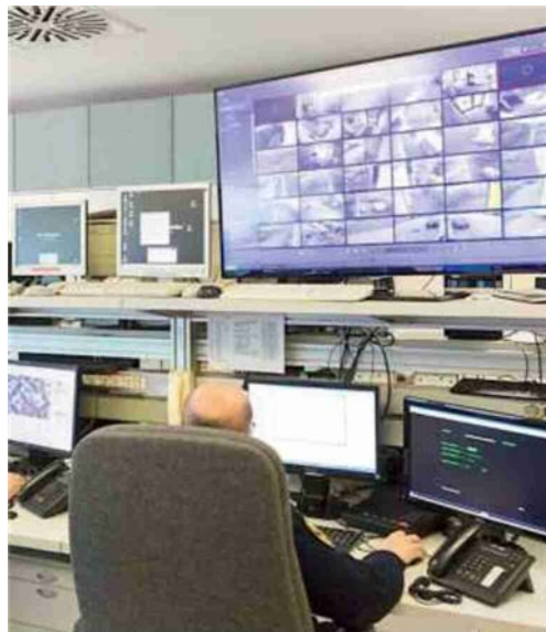
Una postazione di controllo in un impianto di videosorveglianza
