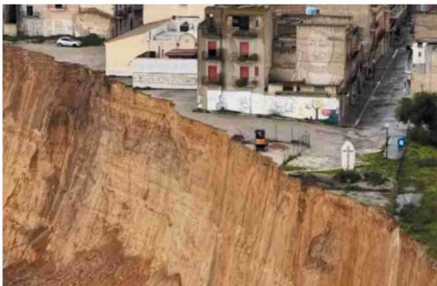
Il fronte della frana
