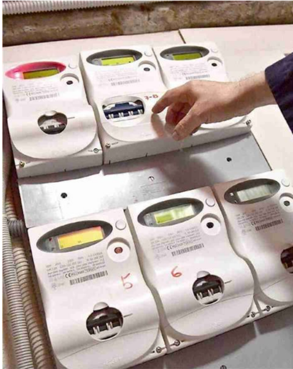
Contatori di energia elettrica
