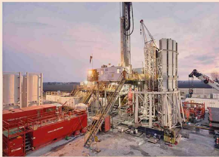
Ferrara. Lavori in corso per un nuovo pozzo alla centrale geotermica di Casaglia
