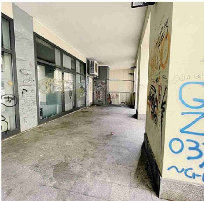
Degrado e sporcizia nelle aree del condominio Edilsauro
